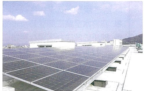
太陽光パネル (屋上・壁面に計40kwの発電システムを設置)
