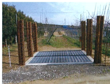
果樹園への設置状況
